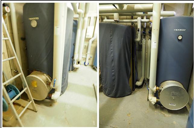
Warmwasserboiler im UG
